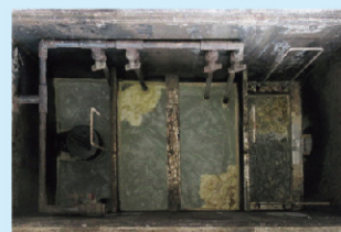
稼働中のグリーストラップ
